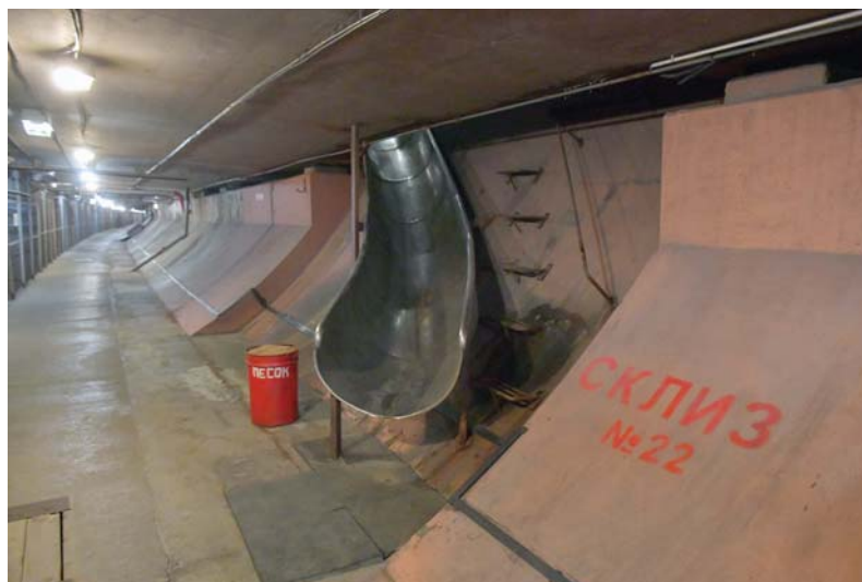
Рис. 9. «Склиз» в Лефортовском транспортном тоннеле
